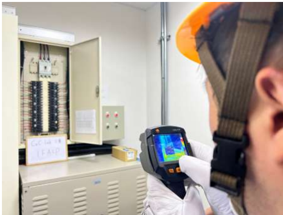
電盤紅外線檢測
